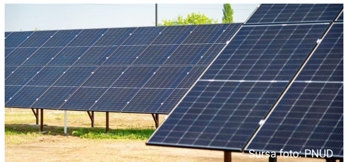
Un sistem fotovoltaic instalat în Molovata, raionul Dubăsari, cu o capacitate de 24 kW pentru pomparea apei și transportul acesteia în localitate
